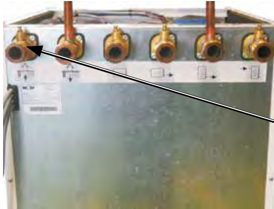
Handentlüfter im Sole-Eintritt
