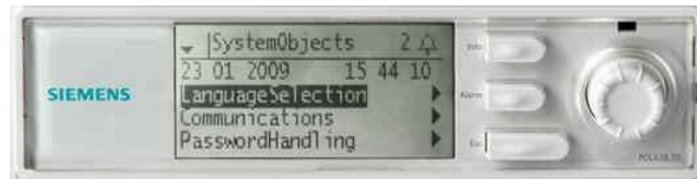
Abbildung 66: Integrierte HMI und Bedienelemente
