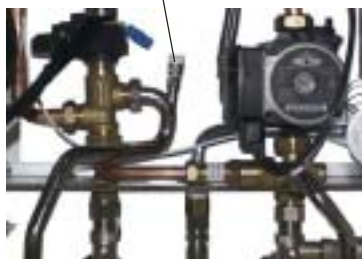
Purga impulsión primario interacumulador
