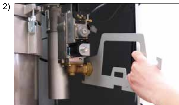
Løsn gasstilslutning ved gasarmaturet
