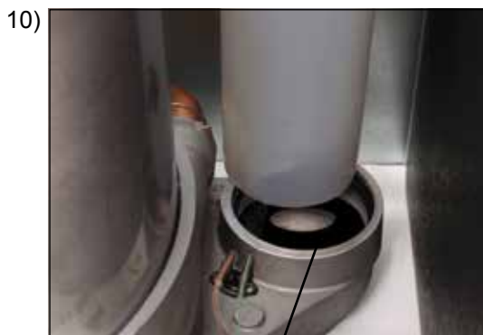
Дроссельная заслонка в дымовой трубе
