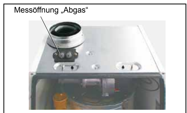
Bild: Abgasmessung bei geöffnetem Gerät
