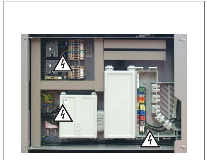
Bild: Steuerungskasten Gefahr durch elektrische Spannung
