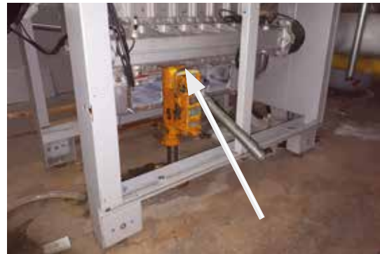
Stempelwagenheber unter Rücklaufrohr
