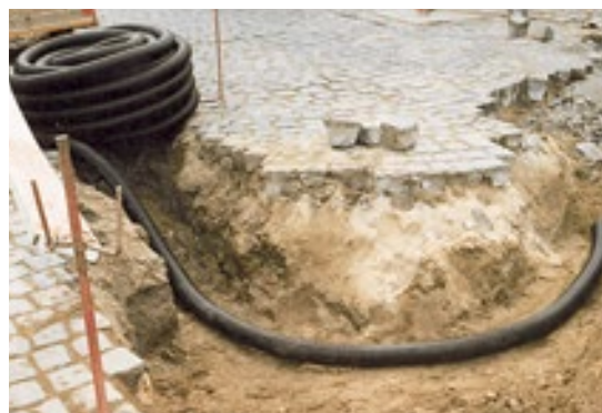
Kabuflex R a Kabuflex R-UV – výhoda v případě nepřístupného terénu a nerovného podkladu
