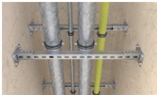
Horizontale Rohrtrasse: PSF
