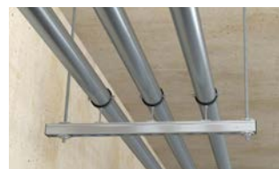
Rohrtrasse auf abgehängter Montageschiene: FAW
