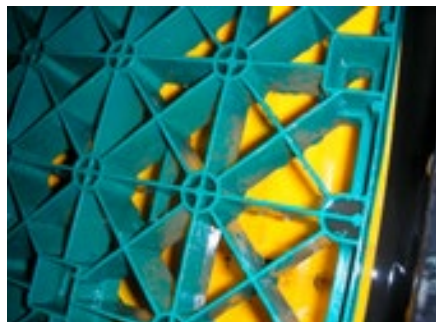
Gereinigte, rückstandsfreie Anlage, hier im Bereich Strömungstrenner
