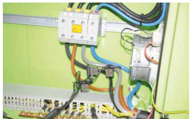
Schnelles Anlegen der Rogowski-Spulensätze durch Klippverfahren an Maschinezuleitung
